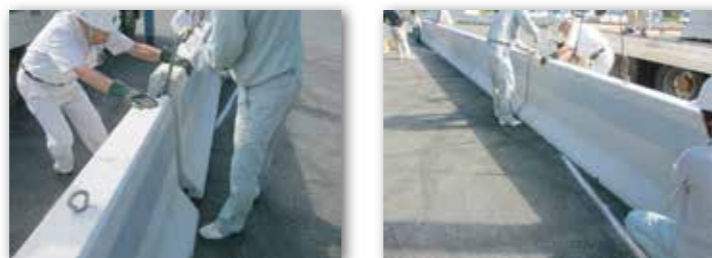
製品の設置状況
