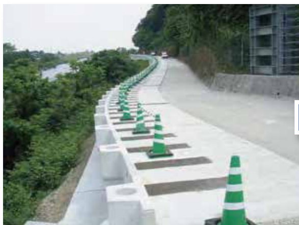
施主：岐阜県揖斐土木事務所 工事名：単県地方特定道路整備事業(緊急防災対策)藤橋池田線
