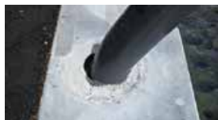
縦断方から見た支柱の変位状況
