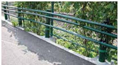
衝突した後の状況
